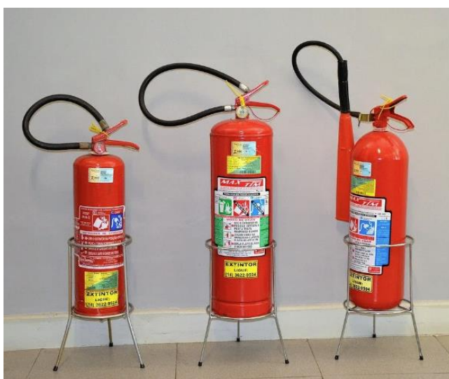
Extintores de incêndio
