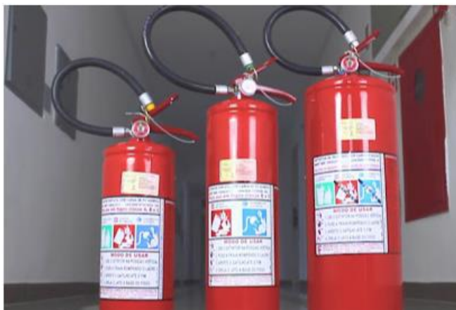
Extintores de incêndio
